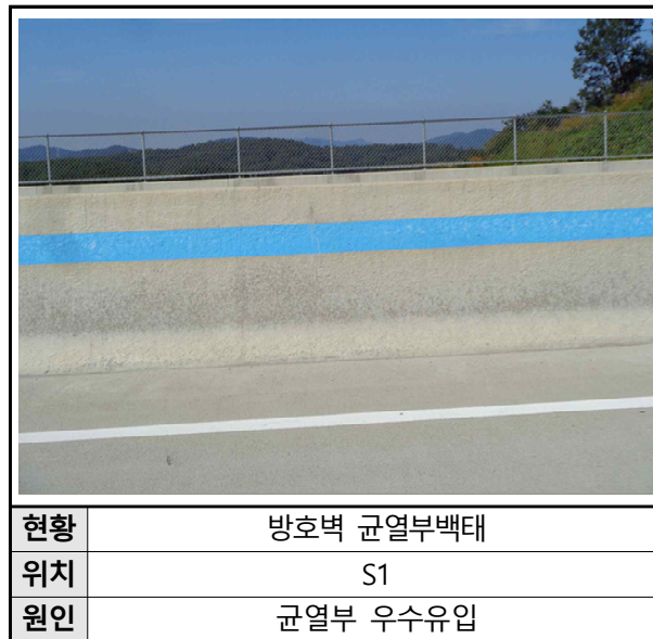
[표 9.3.5] 방호울타리 및 방음벽 손상현황
